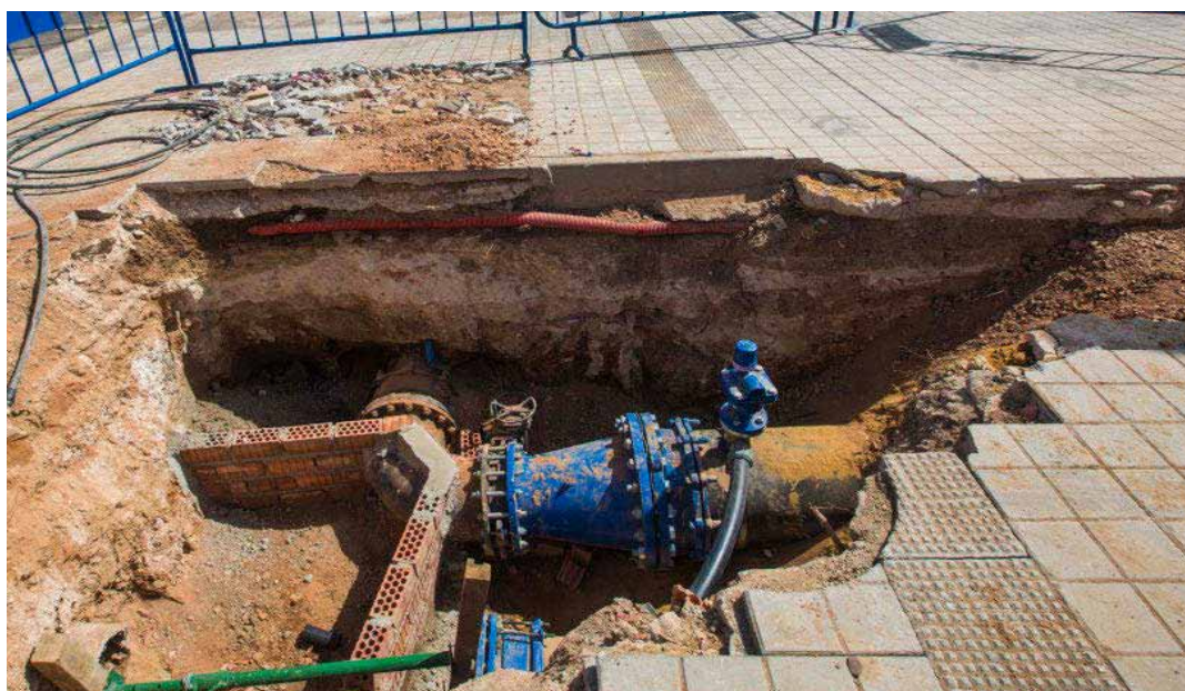
Los proyectos contemplan actuaciones como la renovación de la red, la impermeabilización de los depósitos municipales y la sustitución de equipos de bombeo. / RUEDA
