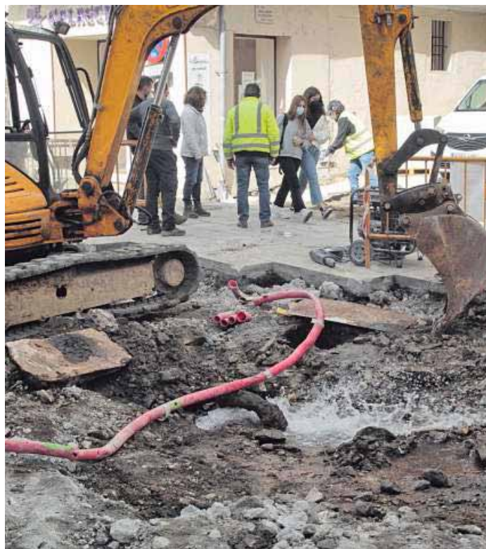
Foto de archivo de un reventón en una tubería en el centro de Monforte. FOTO C. CORTÉS
